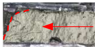
図-12 FP-LT7 の水中ひび割れ注入における動向
