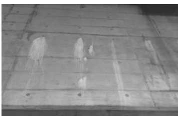
写真-2 学生による点検写真（白華現象）
