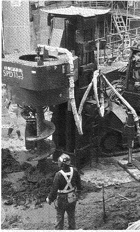
低空頭・狭隘な現場で軌陸式杭打機による春日基礎の施工
