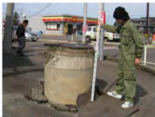
マンホールの浮上り
