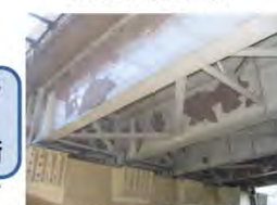
鋼橋の腐食の例
