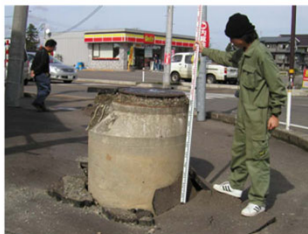
マンホールの浮上り
