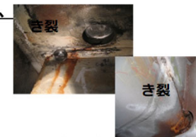
鋼橋の疲労の例
