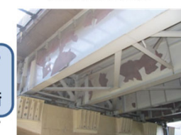
鋼橋の腐食の例
